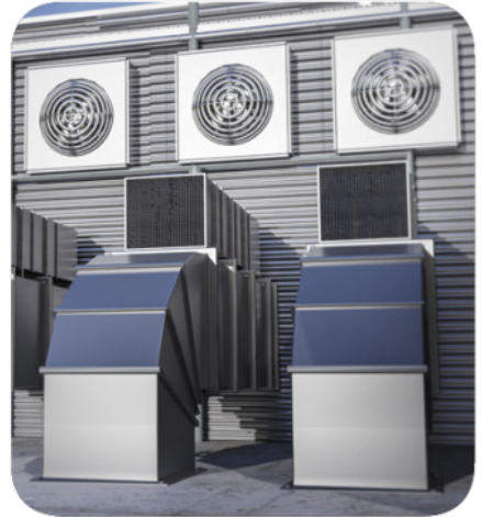
งานเครื่องกลและปรับอากาศ
